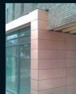
Links; tijdens montage. Rechts; 2 jaar na montage.
